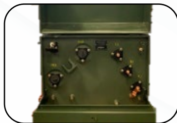
Transformateurs sur socle monophasés
